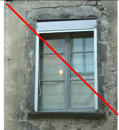
Ci-dessus : les baies traditionnelles ne sont pas conçues pour recevoir des volets roulants extérieurs
