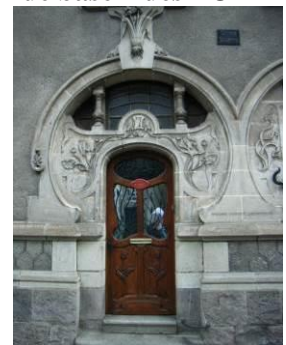
Porte décorative Art Nouveau, en harmonie avec l'architecture de la façade, au début du XX ème siècle. Au milieu du XIX ème et au début du XX ème s, les vantaux de porte sont vitrés ; le vitrage est doublé de grilles décoratives en fonte ou en fer forgé.
