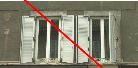
La réduction des menuiseries à un simple vitrage par vantail de fenêtre dérègle le jeu des proportions
