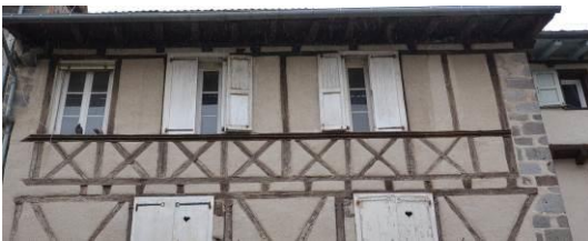
3, rue du Collège. 16 e siècle. Le comble, initialement ouvert, est constitué d'un niveau d'allège en petites croix de Saint-André et d'un cordon d'appui en bois mouluré.
