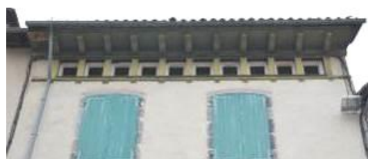
2, rue Marchande, 18 e siècle. Les métopes ont été ouvertes et vitrées pour éclairer le comble.
