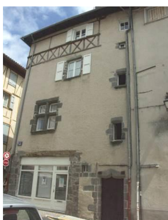
Pan de bois en niveau de combles ouverts (caractéristique d'Aurillac) : petites croix de Saint-André.
