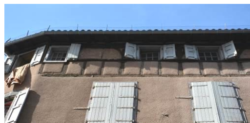
24, rue des Frères. Combles ouvert (15 e – 16 e siècle ?). De grandes ouvertures avec aisseliers ouvraient largement le comble. Les baies ont été partiellement murées lors de l'installation de jours plus étroits.
